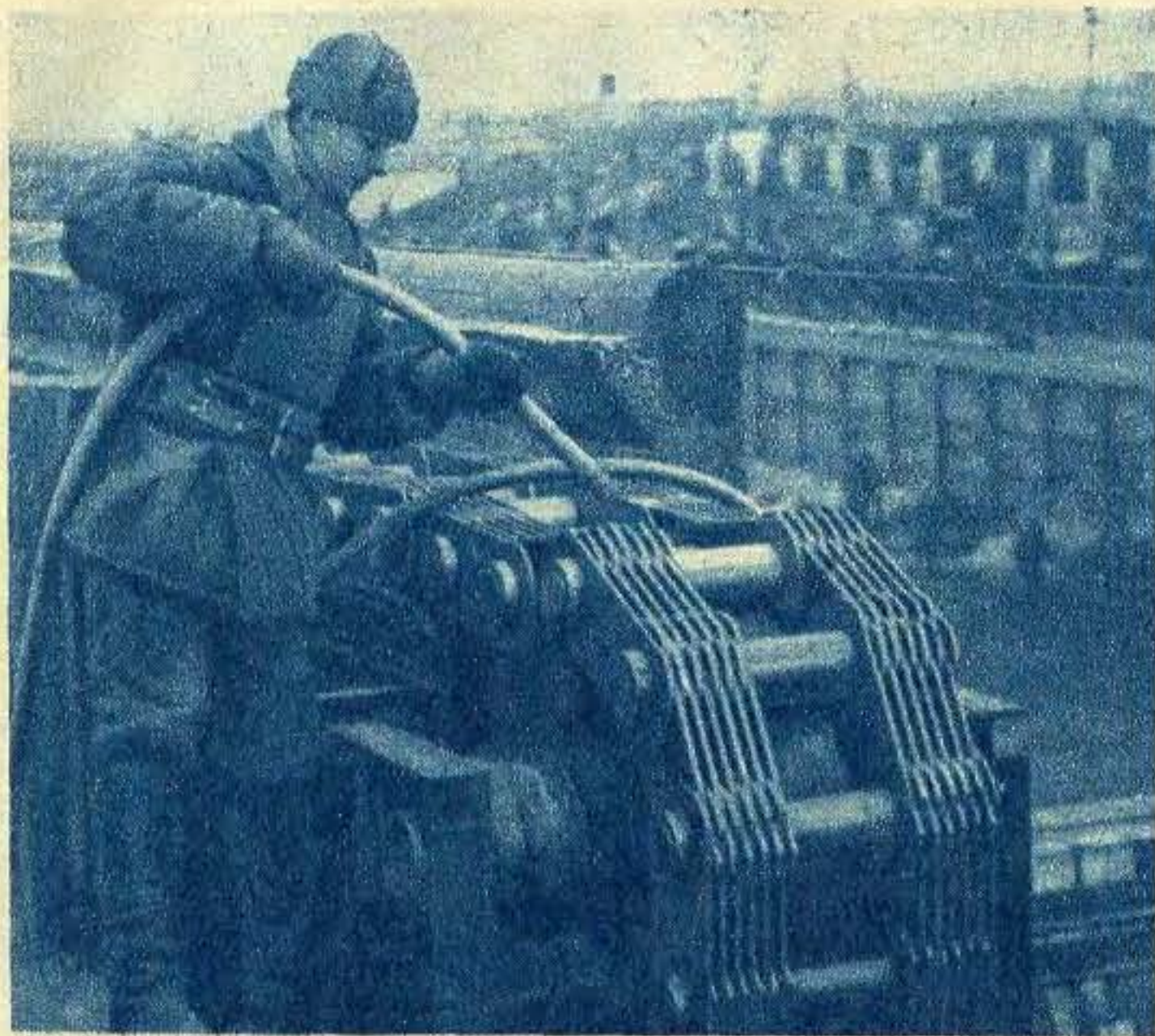
Сегментные затворы и щиты водопроводных галлерей поднимаются с помощью так называемых цепей Галля. Они имеют полное сходство с велосипедной передачей. Две цепи одного механизма весят 10 тонн. Чтобы перевезти их, нужна отдельная железнодорожная платформа.
