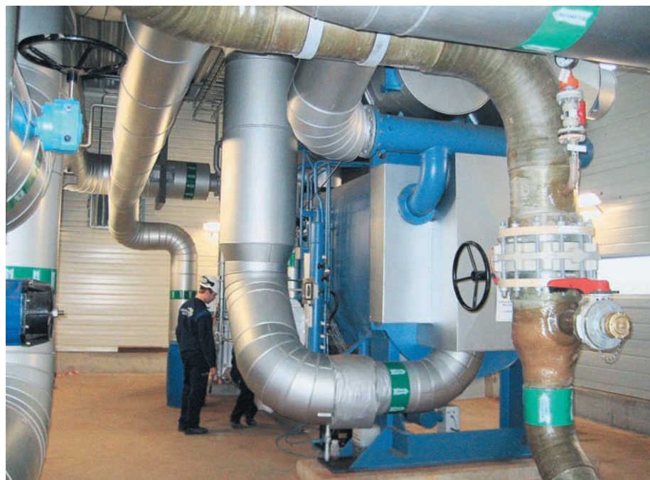
Шведская теплостанция на мусоре
